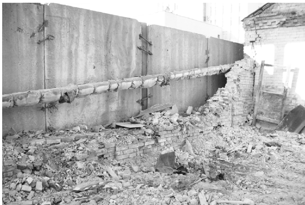
Процесс разрушения сохранившегося фрагмента ограды.
